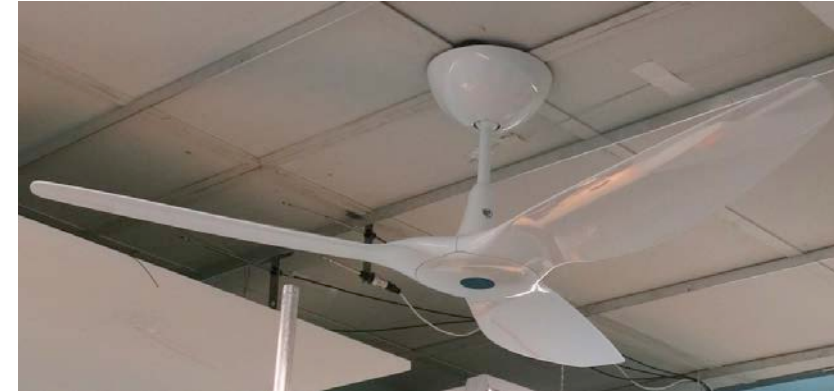
Central ceiling fan
